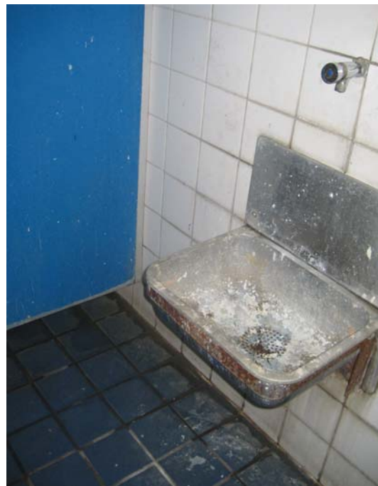
Een strikte controle op het onderhoud is noodzakelijk... (Klein Kasteeltje, Blok BCD 26 september 2008)
