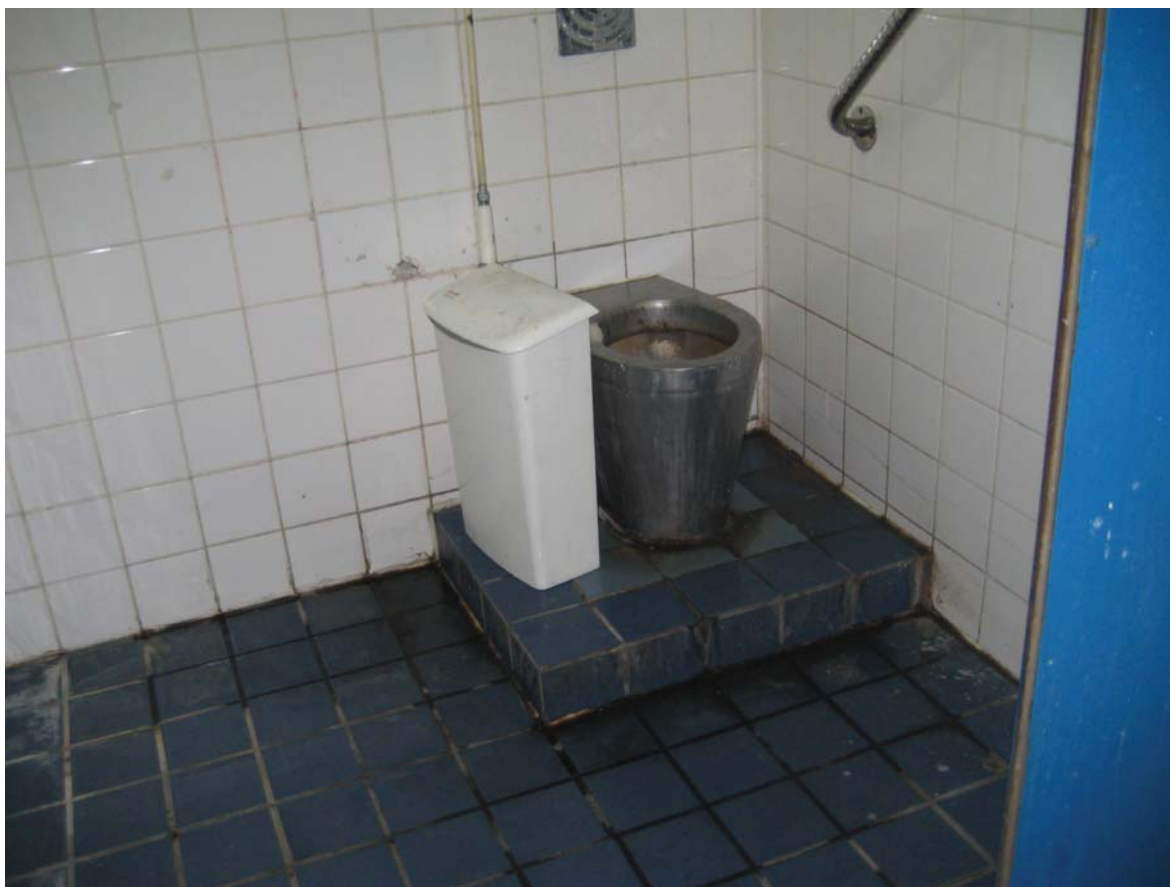
Een toilet voor personen met een handicap. Zelfs waar er "aangepaste" voorzieningen zijn, is de situatie soms verre van ideaal. (Klein Kasteeltje, Blok BCD 26 september 2008)
